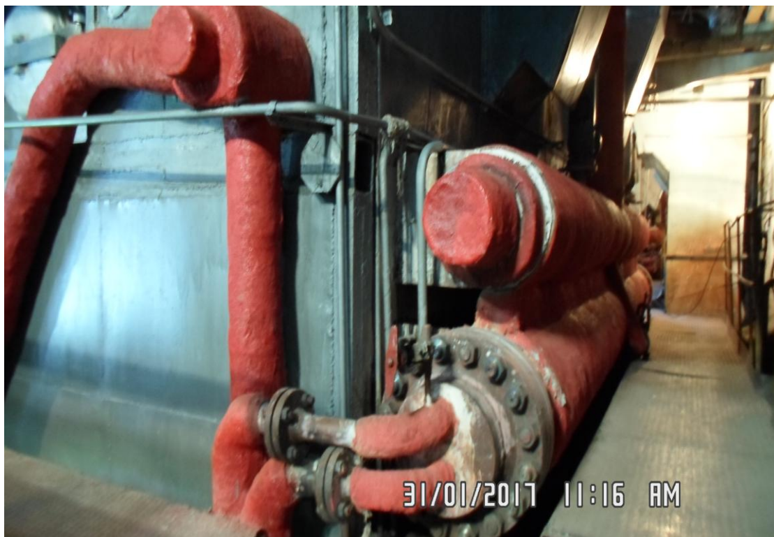
Фото 5 – Пароперегреватель (Котел №1 в работе)
